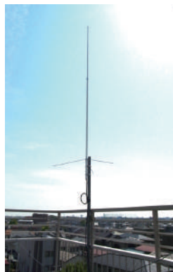
浦和事務所の屋上のアンテナ (GP・DP・LW)
