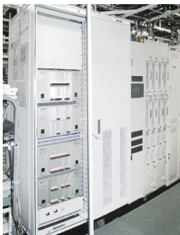
▲左側が通信制御装置、右側が無線中継装置(ビル内)。
